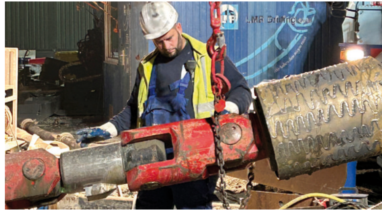
Gearbeitet wird auf der Baustelle rund um die Uhr in zwei Schichten. Foto: NDR
